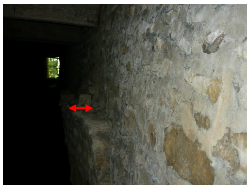
Photo 10 : Déchaussement du mur sur 7 m de long
