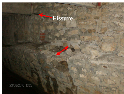
Photo 11 : Fissure au niveau du déchaussement
