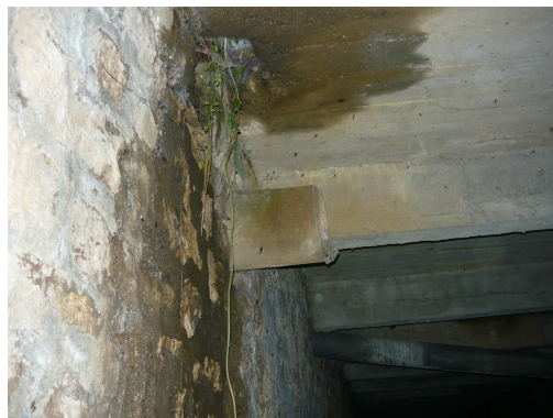
Photo 13 : Buse pluviale et buse d'évacuation
