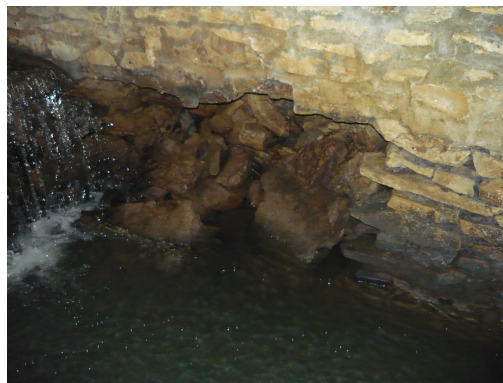
Photo 9 : Chute de pierres en rive gauche
