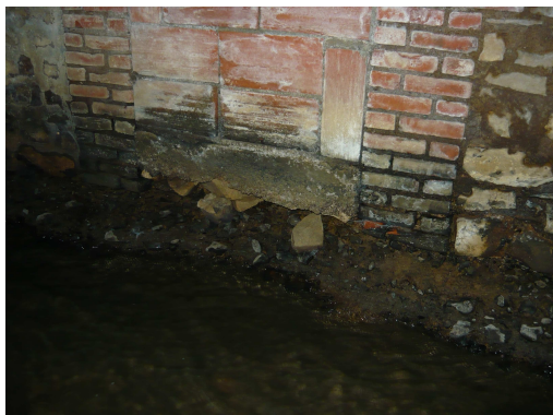
Photo 12 : Mur affouillé en rive droite
