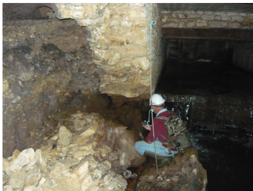
Photo 8 : Effondrement du mur en rive droite
