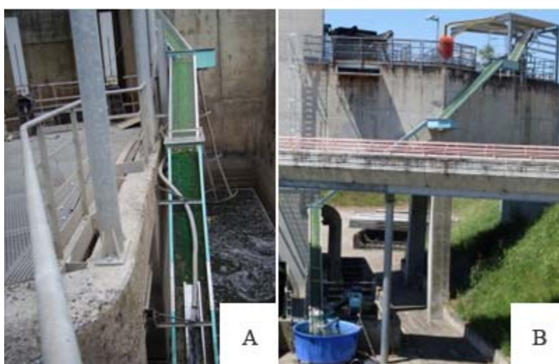
Figure 13 : La passe à anguilles actuelle de Golfech. En A, la passe partie inférieure, en B, la passe partie supérieure.
