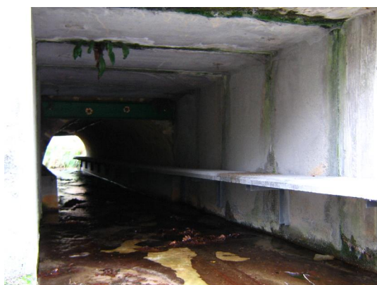
Banquette dans un ouvrage
