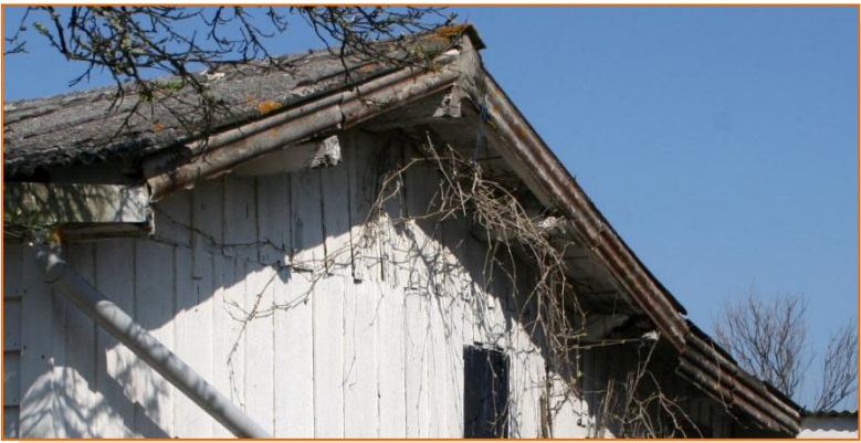
Figure 38 : Couverture et bandeau en tôle métallique petites ondes
