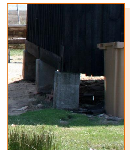
Figure 27 : Parpaings visibles et dépôts de matériaux sous la cabane
