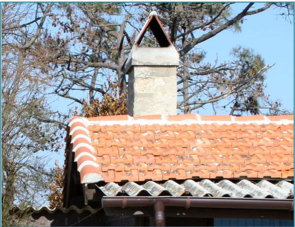
Figure 34 : Couverture en tuile mécanique et "onduline" ciment (auvent)
