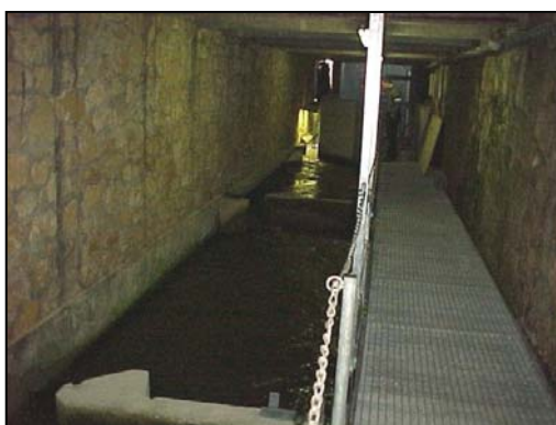
Photo 3: Vue d'un bassin de la passe à poissons de transfert de Tuilières
