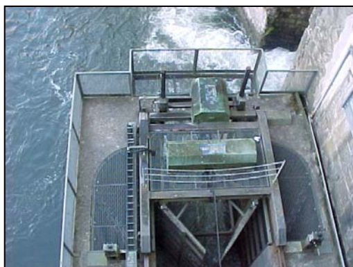
Photo 1 : Vue de l'entrée de l'ascenseur à poissons
