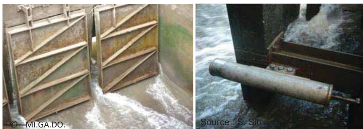
Figure 37 : Raidisseurs installés sur les clapets de la jalle du Breuil. Source : MIGADO et S. Simon, 2010
