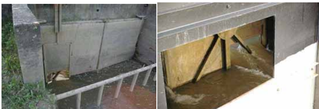
Figure 39 : Vantelle ouverte sur les portes à flot d'Issan, vue de l'aval et de l'amont.
