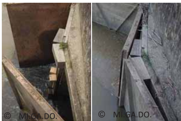
Figure 35 : Des cales en chêne au niveau des portes à flot d'Arcins, à marée basse (portes à flot ouvertes) et à marée montante (portes à flot fermées laissant une ouverture de 10 cm sur toute la hauteur).
