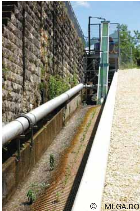
Figure 19 : Passe à anguilles installée sur le site de Tuilières en 2010.
