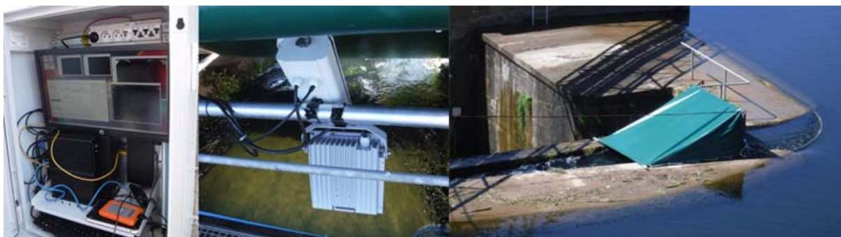
Photo 14 : Le système vidéo de la passe à ralentisseurs du barrage de Mauzac.
