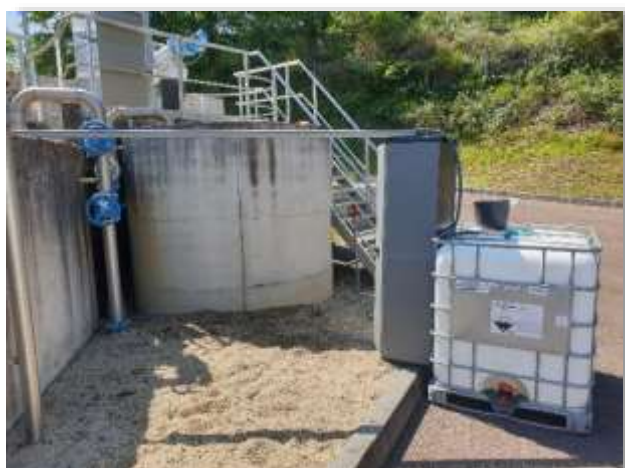
Figure 4: poste d'injection d'acide acétique installé pour les essais
